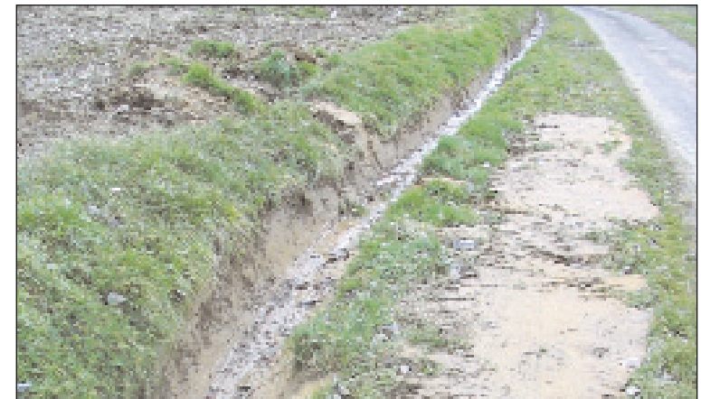
Comblements de fossés, coulées sur les routes, une conséquence des phénomènes érosifs intenses.
